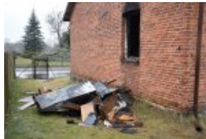
Miejsce działań służb podczas pożaru budynku jednorodzinnego
