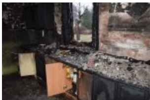
Miejsce działań służb podczas pożaru budynku jednorodzinnego
