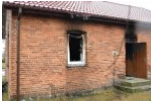
Miejsce działań służb podczas pożaru budynku jednorodzinnego
