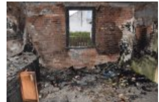
Miejsce działań służb podczas pożaru budynku jednorodzinnego
